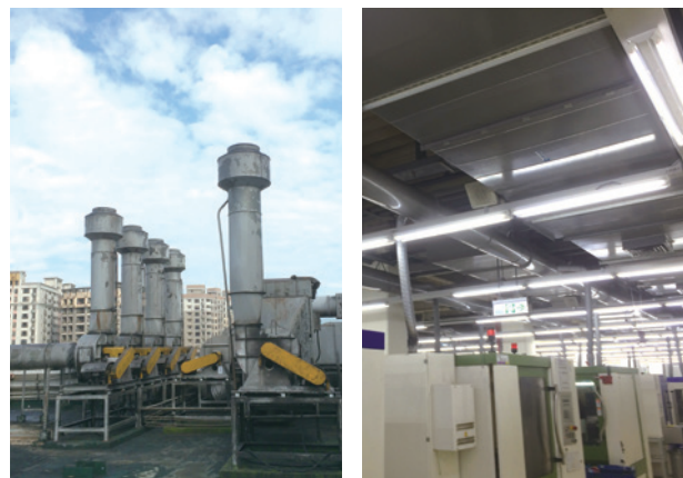
▲ 局部排氣裝置、靜電集塵裝置
